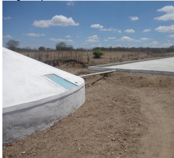
Cisterna calçadão de 52 mil litros
